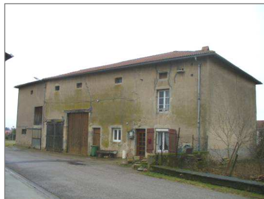
Petits muret dégradé situé dans une ruelle.
